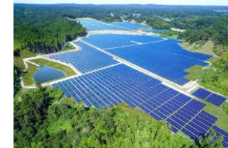
リエネ長南太陽光発電所 (千葉県長生郡)
